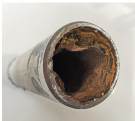
Korriertes und verkrustetes Rohr
